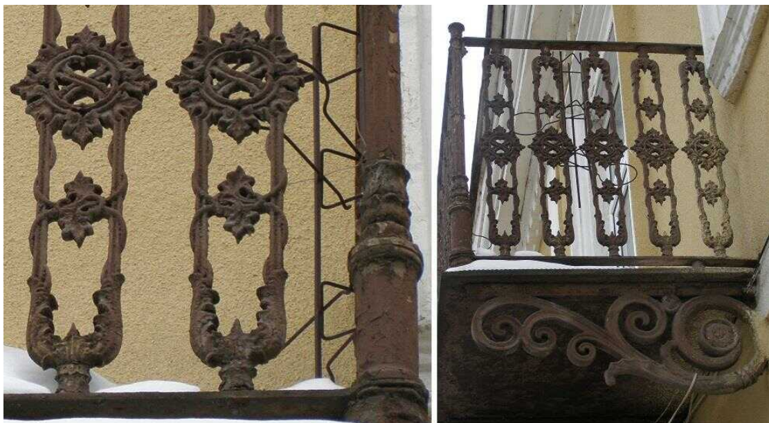
Іл. 3. Огородження балконів і кронштейни будинку по вул. Гетьмана Мазепи, 1 - Вічевий майдан (1827-30-ті рр.).
