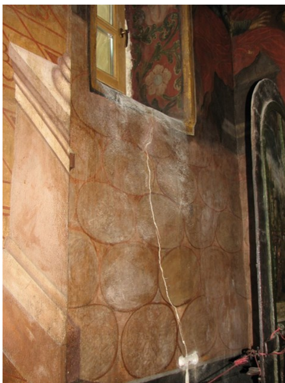
Б. Рис. 142. Конструктивна тріщина на західній стіні північного нефа. Фото В. Зайцевої
