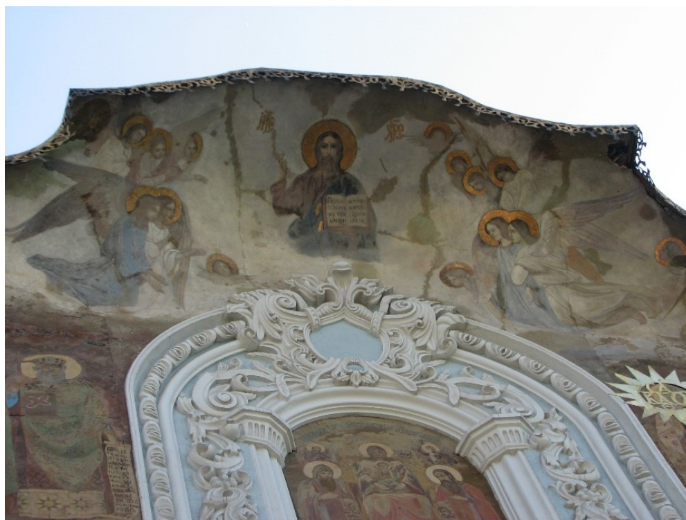
Б. Рис. 122. Фронтон західного фасаду до реставрації. 2018 рік. Фото В. Зайцевої
