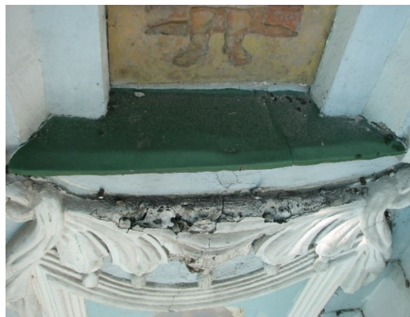
Б. Рис. 131. Стан ліпного оздоблення фасадів. 2019 р. Фото В. Зайцевої
