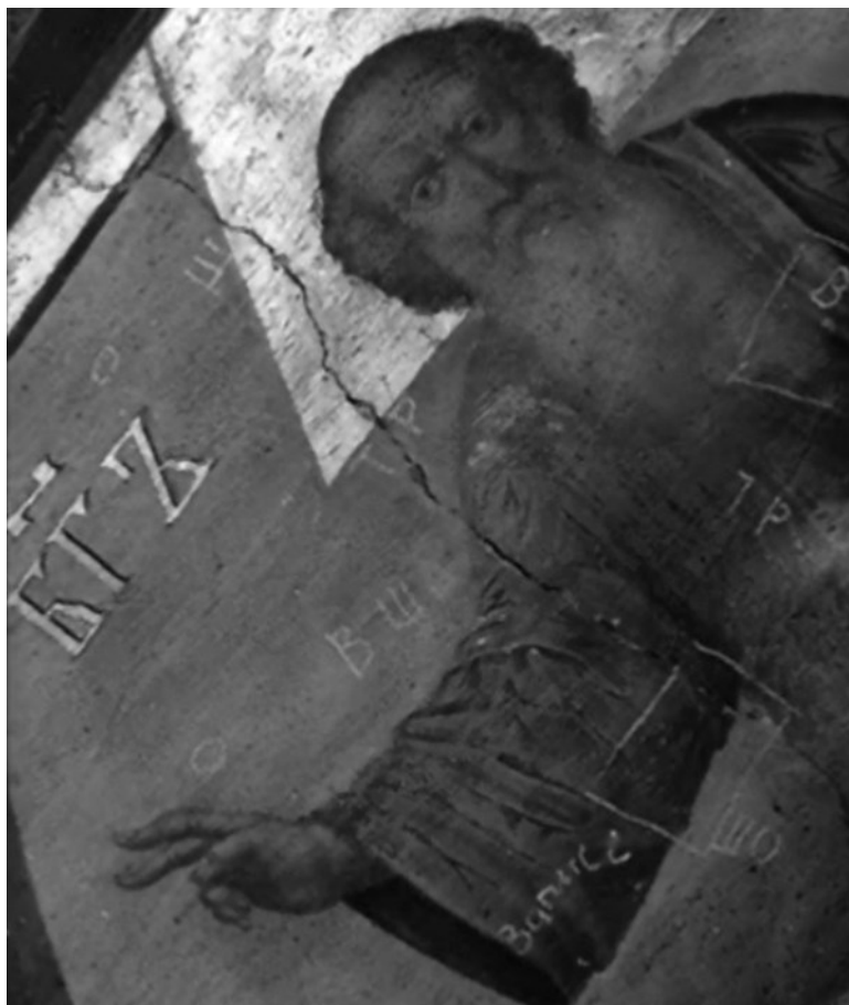
Б. Рис. 48. Конструктивна тріщина на ділянці склепіння тріумфальної арки (композиція «Бог Отець»). 1979 р. [47]
