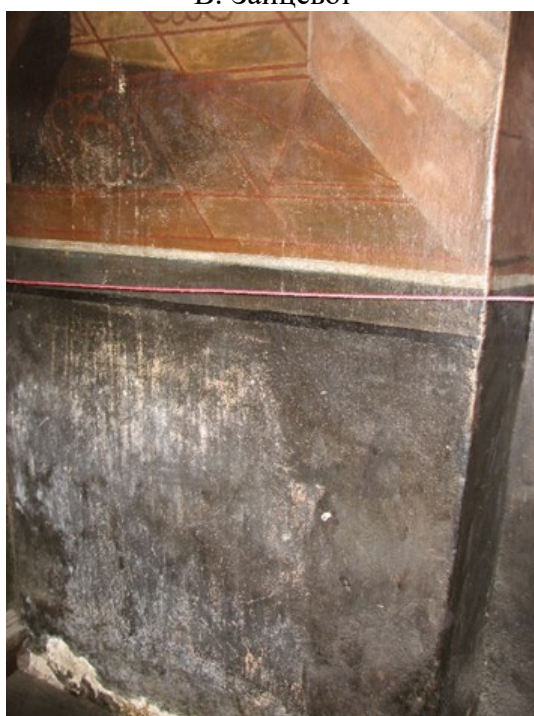
Б. Рис. 146. Осередки виносу водорозчинних солей на поверхні нижньої частини західної стіни (ямчуг). Фото В. Зайцевої
