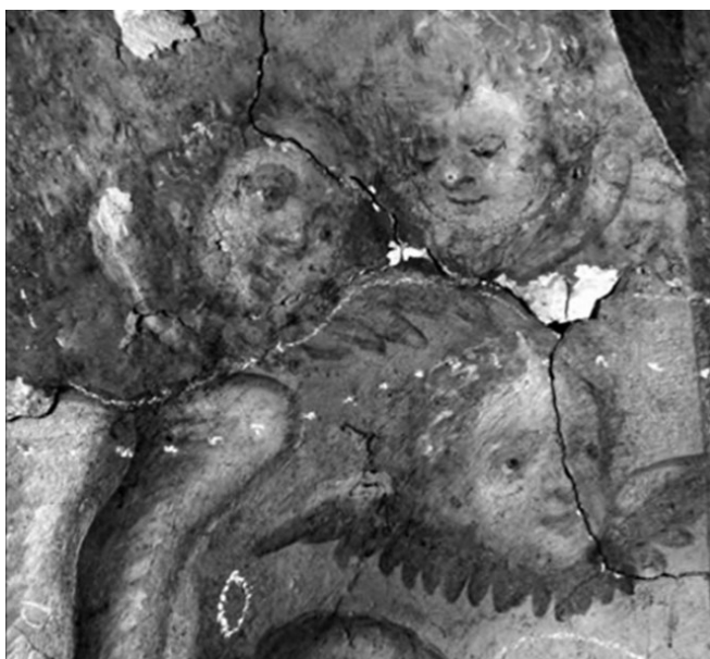
Б. Рис. 50. Втрати фарбового шару вздовж конструктивної тріщини на склепінні центрального нефу (фрагменти композиції «Св. Трійця Новозавітна») [47].
